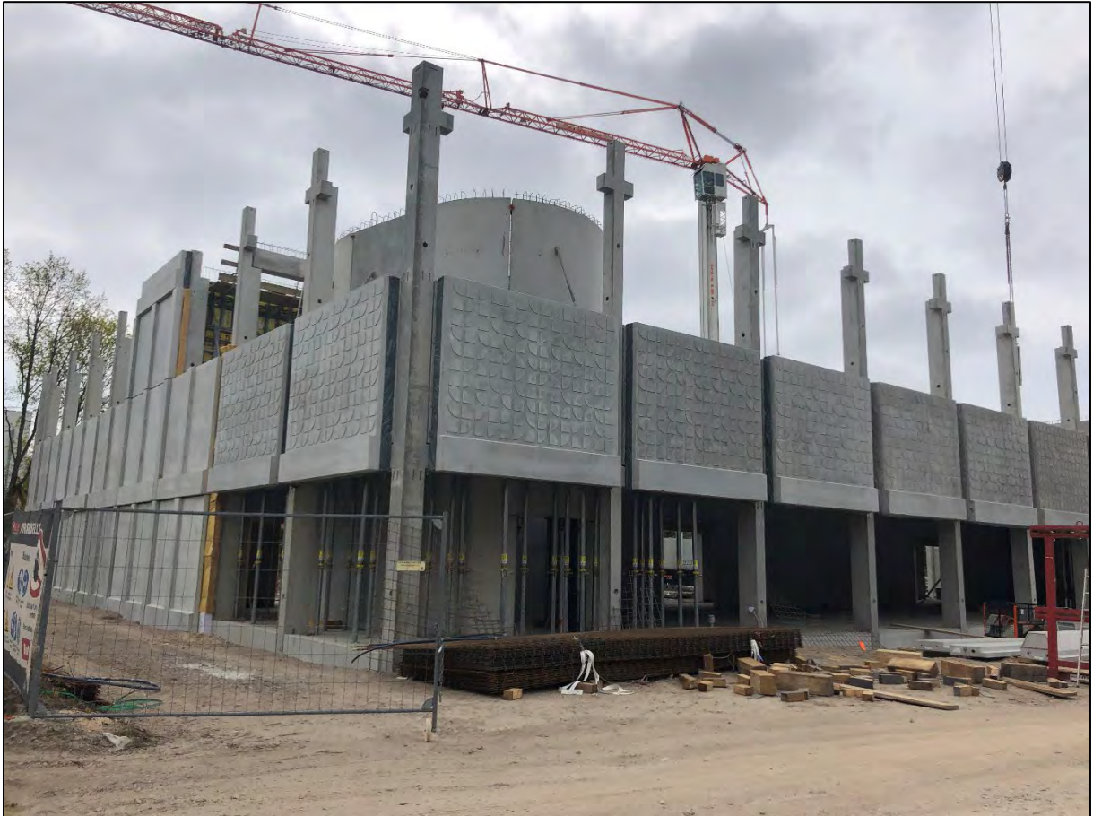
Ansicht Sporthalle von der Grundstücksgrenze an der Ernst-Ludwig-Heim-Straße, auf Höhe des Gehwegs zum Haupteingang
